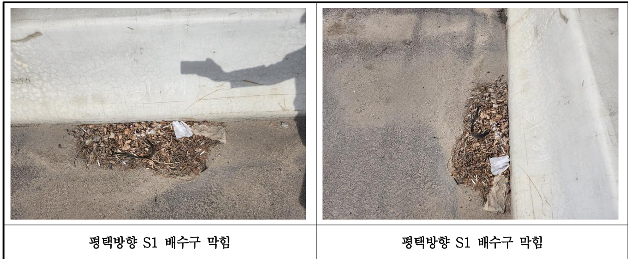
【사진 2.3.20】 배수시설 손상현황(계속)
